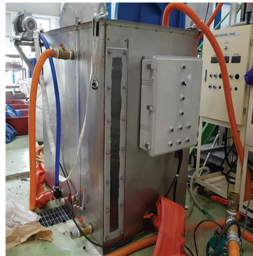
(d) 10 ton filtration system
